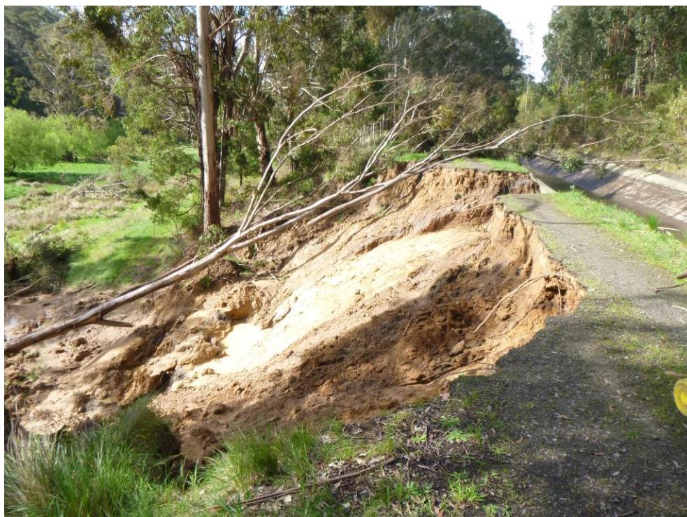
Figure 1: Wurdee Buloc Inlet Channel Embankment Failure
